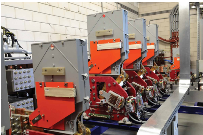
Figuur 1: Onderdeel van de 20kA voeding. In rood de DC circuit-breaker verbonden met de busbars van de 20 kA voeding. In oranje de vlamboog schilden die als bescherming dienen wanneer de circuit breakers geschakeld worden onder vollast.
